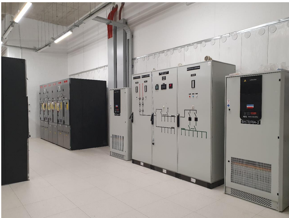
Nova subestació elèctrica de tracció de Bellaterra, situada entre les dues ja existents a Sant Cugat i Sant Quirze.
